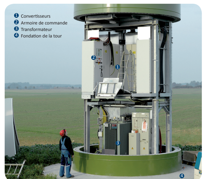
Composants électroniques dans le mât d'une éolienne
